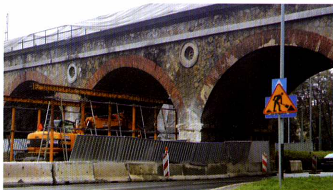
PKP obiecywała, że nowy wiadukt zostanie obłożony kamieniami z tego prawdziwego, aby przynajmniej robił wrażenie zabytku. Niestety, część płyt z dwóch filarów została już zniszczona.
